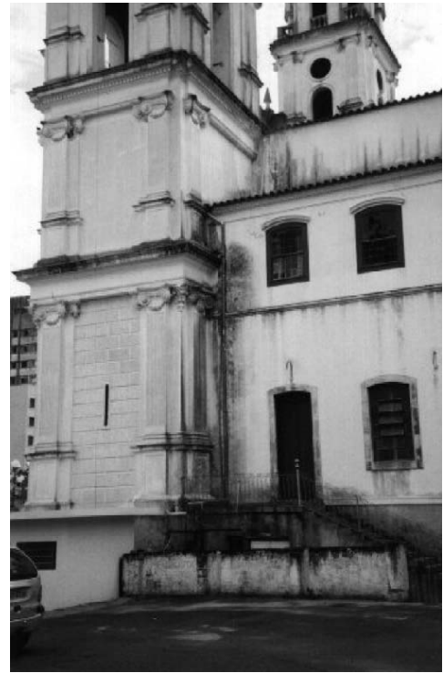
Figure I-2 : Eglise « Nossa Senhora das Dores » (Porto Alegre, Brésil) montrant des biofilms noirs au niveau des infiltrations d'eau (Crispim et al. , 2004)
